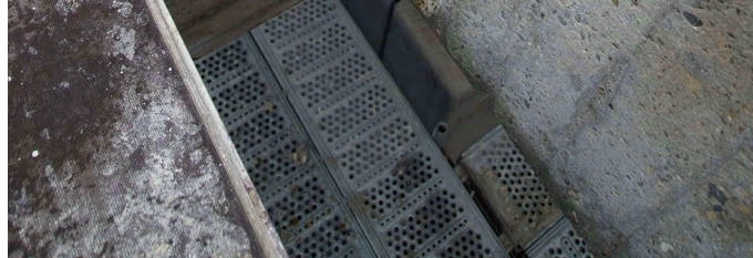
freigelegter Armierungsstahl am Dachumgang
